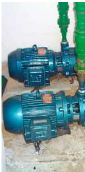
Bombas, motobombas e motores elétricos trifásicos
